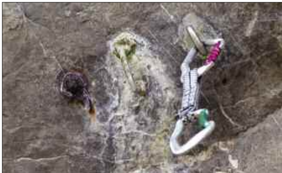
Ταϊλάνδη, η κατάσταση των βυσμάτων.
