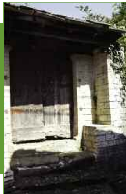
Το κτίριο της Αναγνωστοπούλειου σχολής στο Δίλοφο σε πλήρη εγκατάλειψη.
